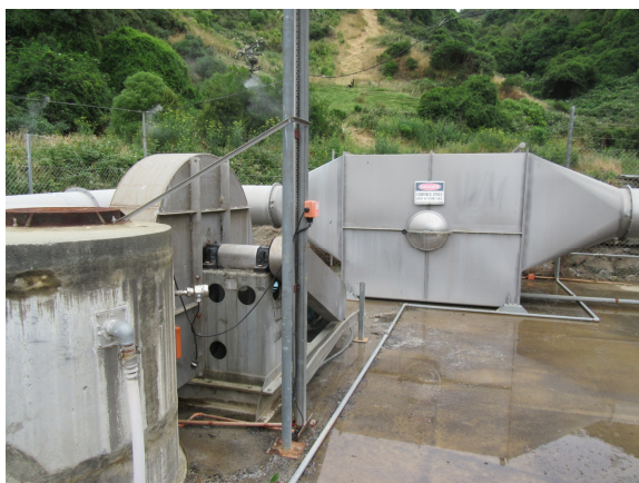
BIOFILTER FAN AND HUMIDIFIER
